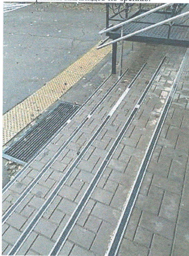
Фото 8. На фото 8-9 вход в здание, оборудованный бетонной тактильной плиткой для инвалидов по зрению, и противоскользящими накладками на ступени.
